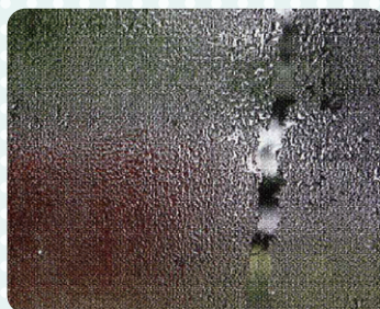
1枚ガラス(5ミリ)を使用した場合 結露が発生しています
